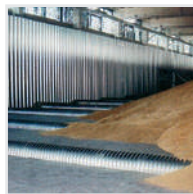
Canali di ventilazione Ventilation ducts
